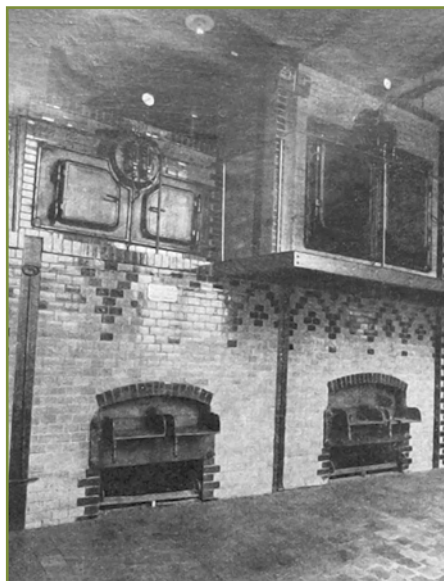
Vysokotlaké kotle s keramickým obložením.
