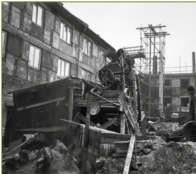
Míchací centrum na dvoře čp.1485.
