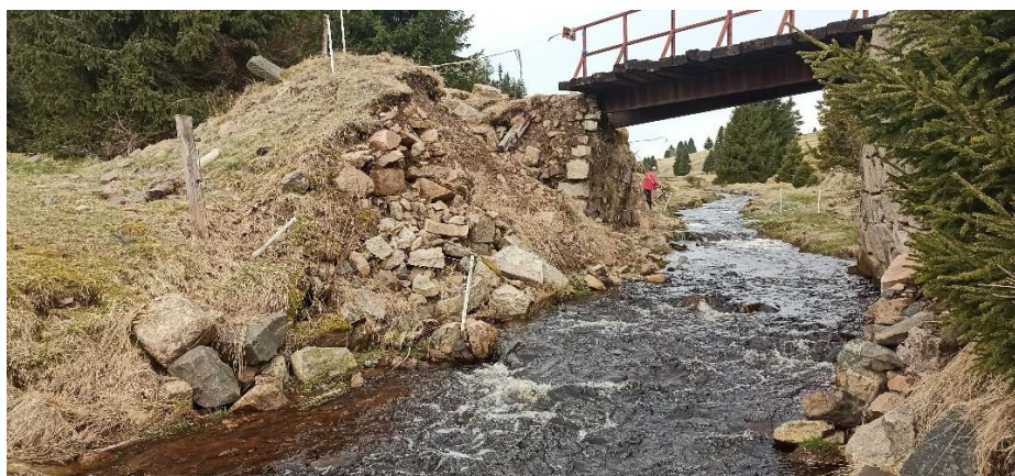
Foto: Havarijní stav mostu v r. 2022
